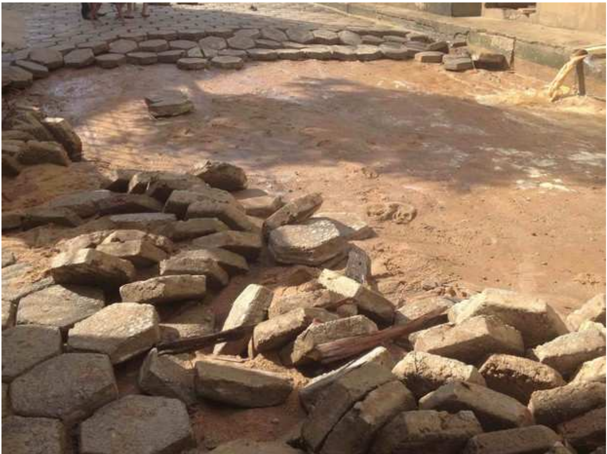
Enxurrada arrancou calçamento em rua de Colatina (Foto: Solange Menechine/ VC no ESTV)
